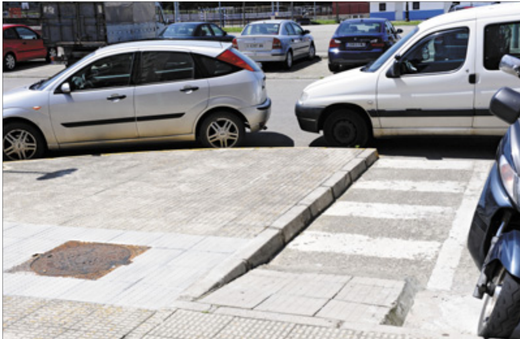
Rampa de acceso para personas en silla de ruedas en un paso de peatones, totalmente bloqueada por varios vehículos mal estacionados. / DELTA
